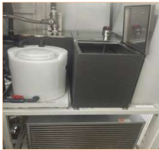
内部处理系统
